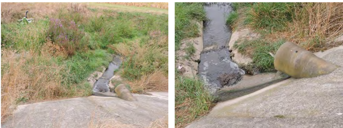
Figura 18. Canal evacuare apă de la SEAU Filipești
